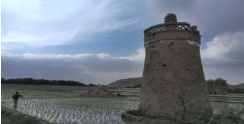
تصویر ۴. تخریب پی کبوترخانه به دلیل نفوذ آب مزارع برنج، روستای ونهر، بلوک لنجان، (عکس از ژاله کمالی‌زاد، ۱۳۹۴)
